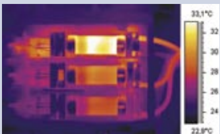
Innere Beschädigung einer Sicherung
