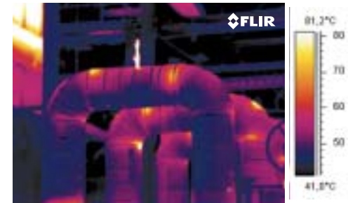
Rohrleitungen in der Chemieindustrie
