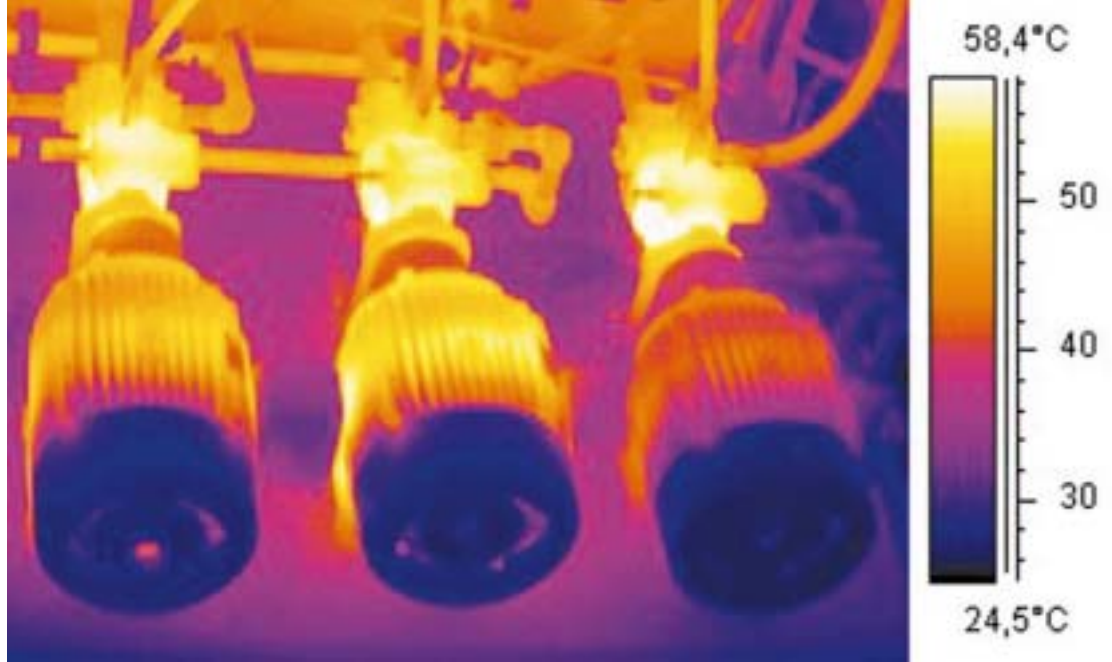
Elektromotoren: der rechte Motor ist deutlich kälter - ein Indiz für niedrigere Leistung
