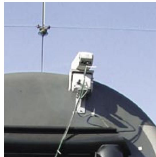
Infrarotkamera ThermoVision A40 von FLIR Systems in einem Gehäuse an einem Testwaggon.
